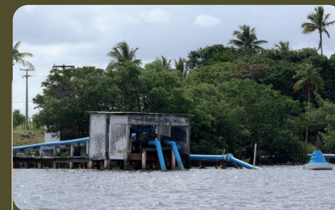
Estrutura de bombas de captação de água para os tanques de camarão, Ouricuri.
